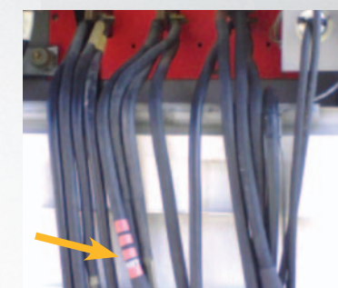
Distribución de la energía, completa y visible
